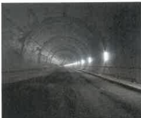
Línea de alta velocidad Valladolid-León. Túnel Valladolid-Venta de Baños. Castilla y León.
